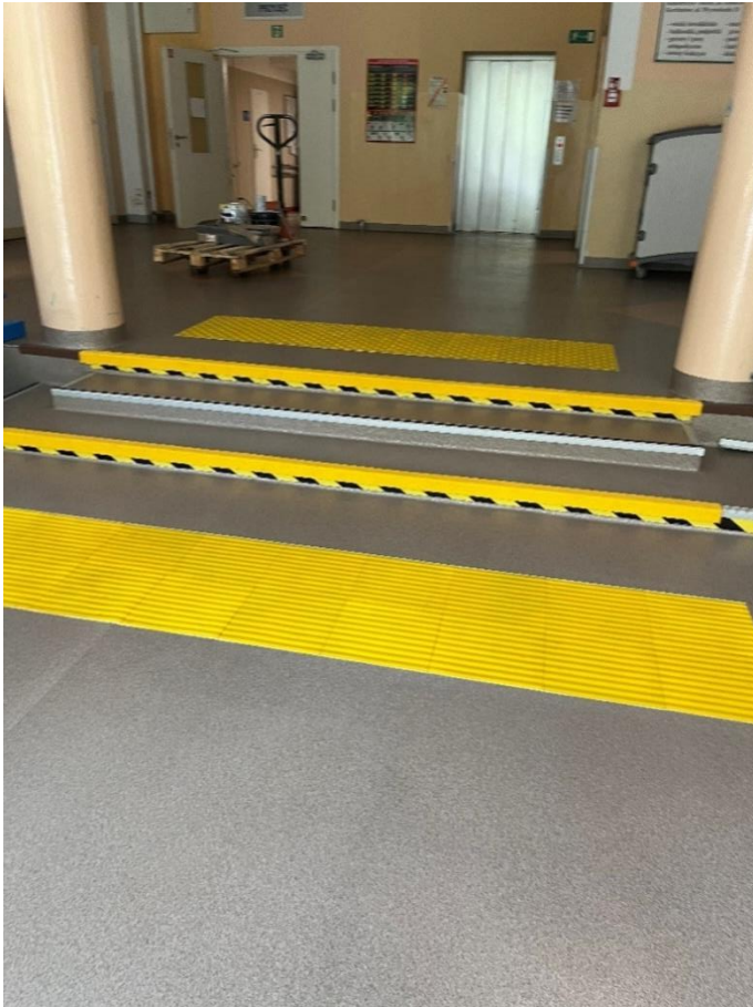
Zdjęcie nr 4 – oznaczenia kontrastowe i ostrzegawcze na schodach
