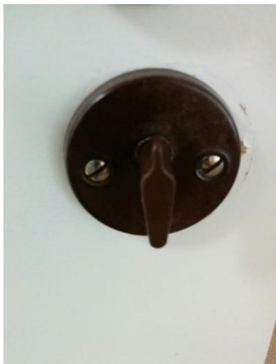
Zdjęcie nr. 4 Niepoprawne zamknięcie toalet dedykowanych dla osób ze szczególnymi potrzebami
